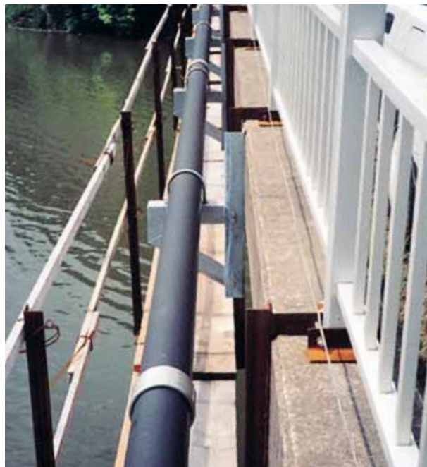
▲ 上水道橋梁添架配管/塩ビライニング鋼管
