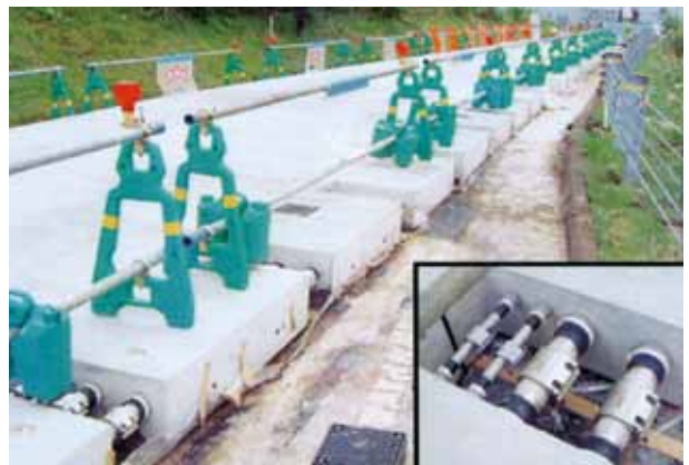
▲道路設備/消雪配管(プレキャスト方式) ステンレス鋼管
