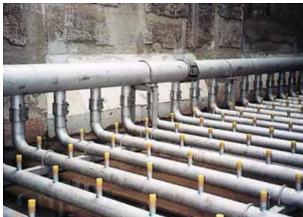
▲ 廃棄物処理施設/散気設備ディフューザー配管 ステンレス鋼管
