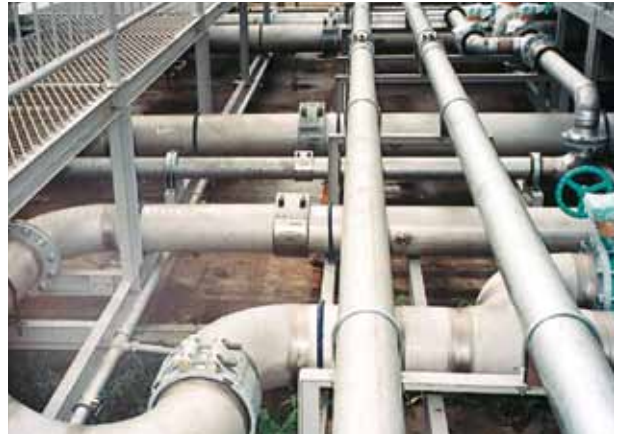
▲薬品工場空調設備/冷温水配管 ステンレス鋼管
