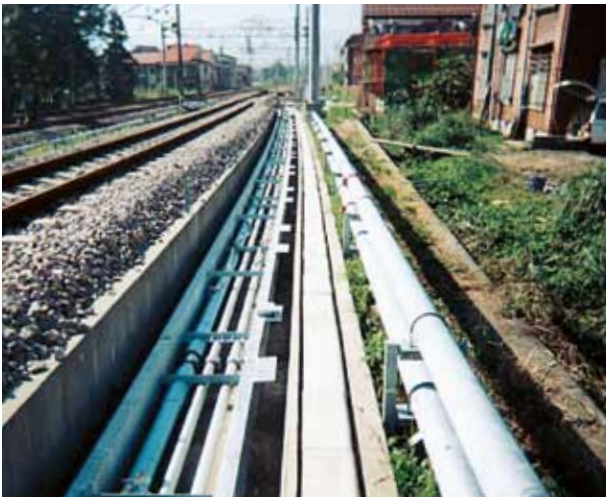
▲鉄道パネル循環融雪配管/鋼管(白ガス管)
