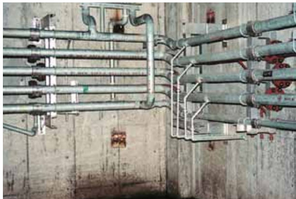
▲ びみ焼却場/焼却炉冷却水配管 鋼管(白ガス管)
