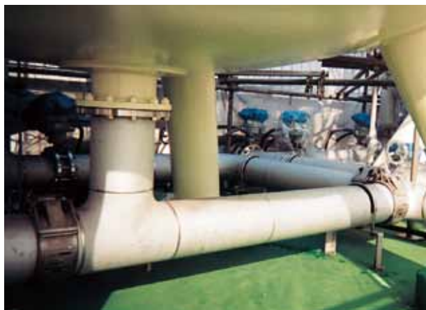
▲ 浄水場/ろ過装置廻り配管 ステンレス鋼管
