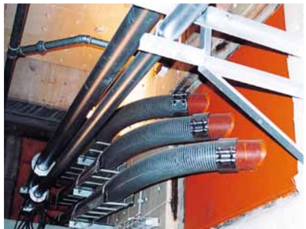
▲清掃工場/消石灰吹込配管 鋼管+塩ビホース
