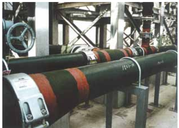
▲清掃工場/冷却水配管 タールエポキシ配管(CLP)
