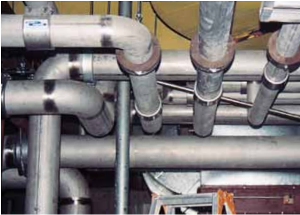
▲スポーツセンター/空調冷温水配管 ステンレス鋼管
