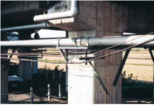
▲鉄道消雪配管/塩ビライニング鋼管
