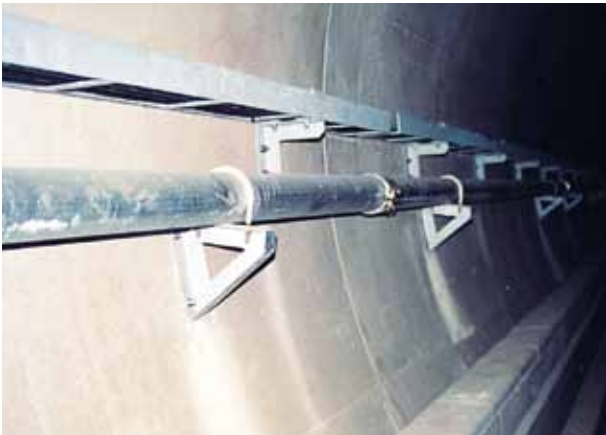
▲地下鉄消火配管/鋼管
