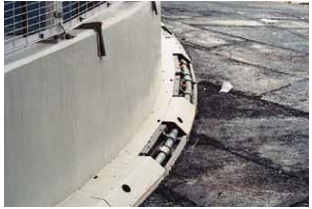
▲道路設備/消雪配管(カーブ配管) 鋼管
