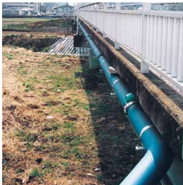
▲ 上水道橋梁添架配管/プラスチックライニング鋼管(PPLP)
