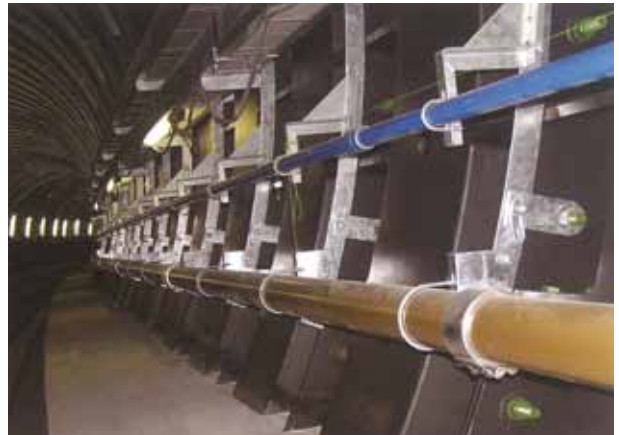
▲地下鉄消火配管/連結送水管 VF管
