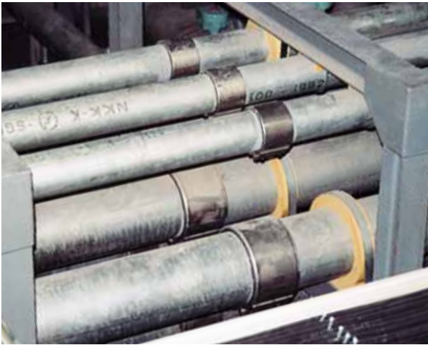
▲ビル空調設備/冷却水配管 鋼管(白ガス管)
