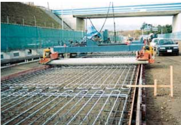
▲道路設備/温水循環融雪配管 ステンレス鋼管
