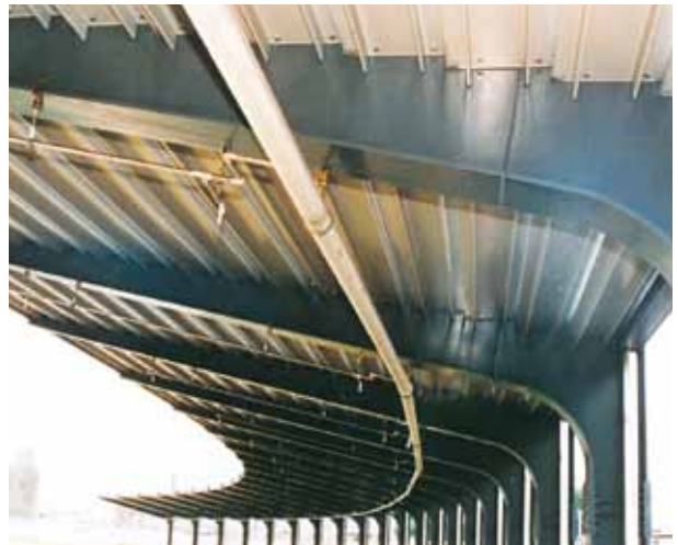
▲競技場散水配管/カーブ配管 ステンレス鋼管
